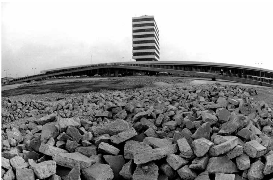
Construcción del aeropuerto Jorge Chávez durante el gobierno de Belaunde (archivo diario El Peruano ).
