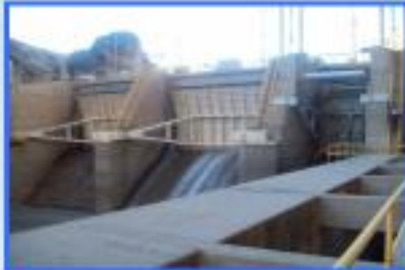
Bocatoma de Tuti Captación: 34 m 3 /s
