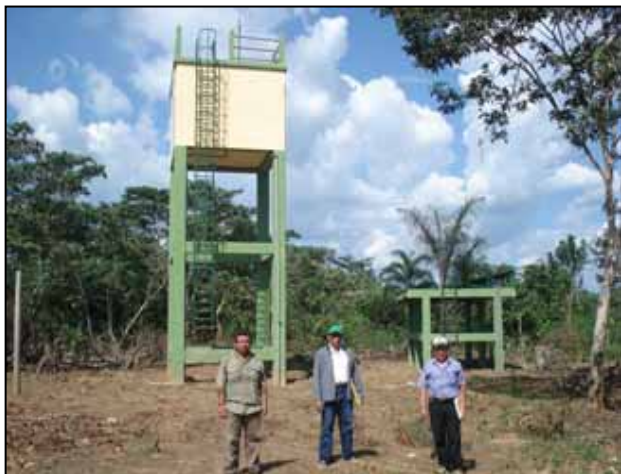
Vista del sistema de almacenamiento de agua Sector 4 para su distribución a la población beneficiaria. A la derecha se observa el soporte de los paneles fotovoltaicos.
