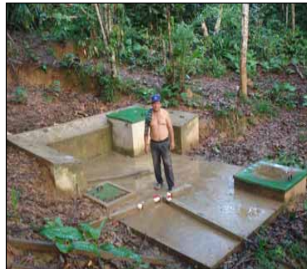
Vista del sistema de captación de aguas subterráneas, proveniente de puquiales (ojos de agua) existentes en la localidad
