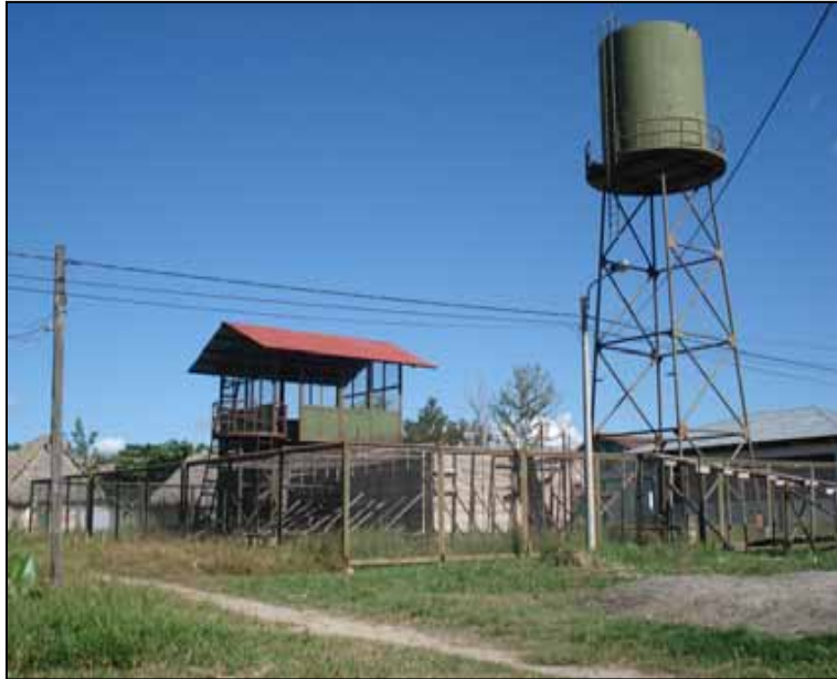
Vista de la zona de Planta de Tratamiento, Tanque Elevado y Caseta de Insumos del Sistema de Agua.
