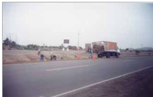
Personal realizando labores de mantenimiento y limpieza del separador central y reconfiguración de talud
