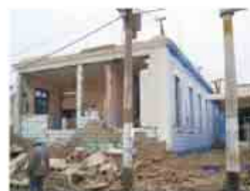
F-4.10.4 Severos daños en un hospital.
