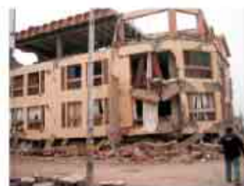
F-4.10.5 Colapso del Hotel Embassy. Las columnas de los primeros pisos fallaron completamente.
