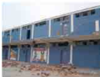
Colegio Bandera del Perú (dañado).
