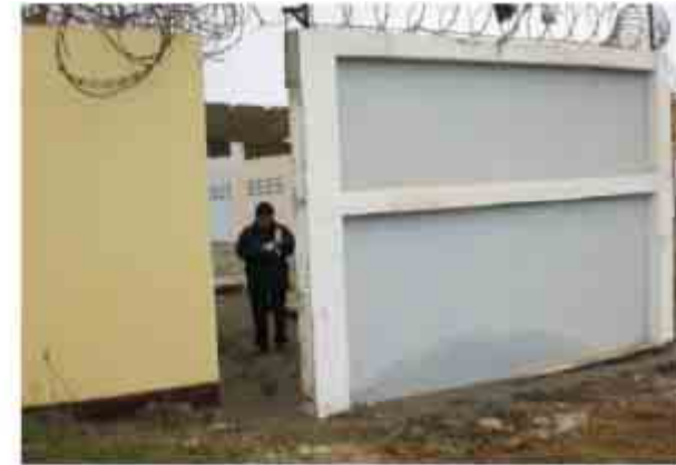
F-4.13.3 Desplazamiento horizontal del suelo ( lateral spread ). Los muros estaban unidos y se abrió una "puerta".
