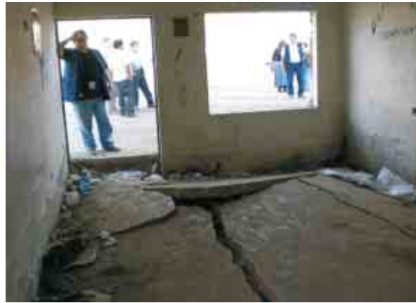
F-4.13.5 Los muros, por su propio peso y el de los techos, se hundieron más que los pisos que se "levantaron", quedando las viviendas totalmente inhabitables.
