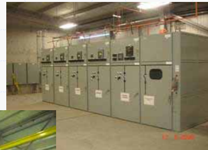
Celdas de Media Tensión en CT
