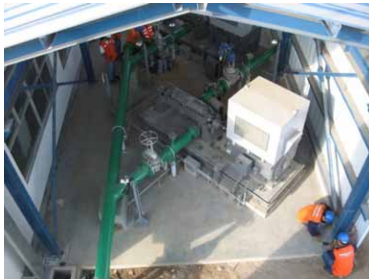
Bomba de agua
