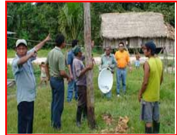
Habilitación del mástil de soporte de la antena de cable en beneficio de los comunos de Nuevo Jerusalén
