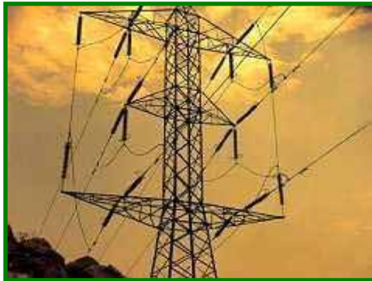
Suministro de energía eléctrica
